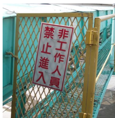
帶運機走道入口設置閘門管制
