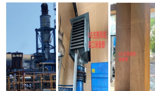
(左一為林園先進廠設置消音器，中間及右邊則為馬鞍山廠之主控風機消音器及消音板)
